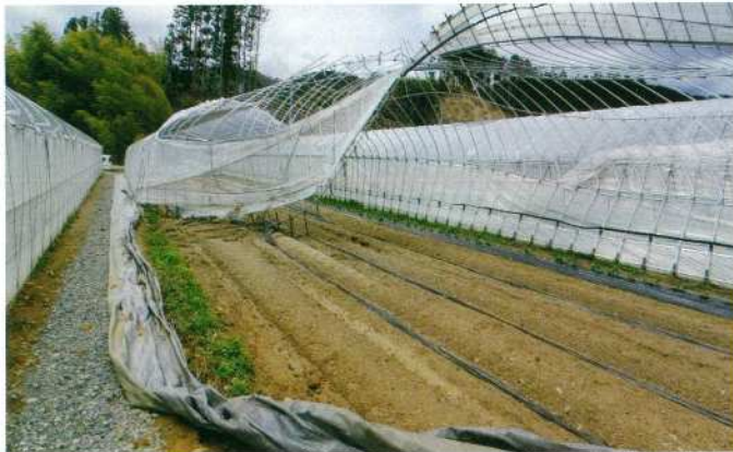
▲台風で吹き飛ばされたハウス
