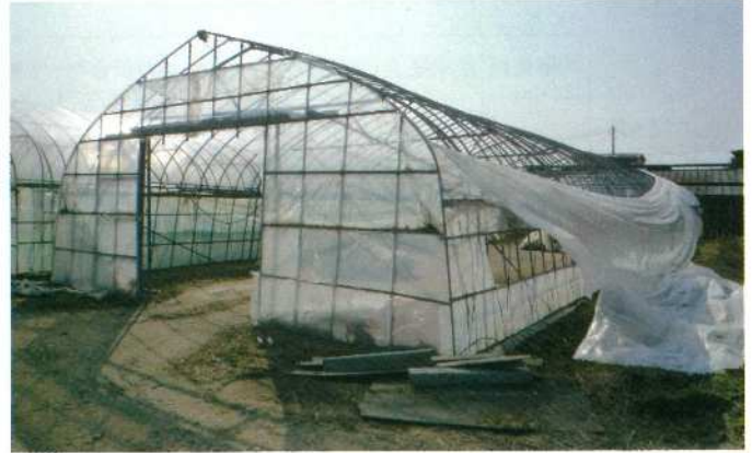
▲強風により被覆材に被害を受けたハウス
