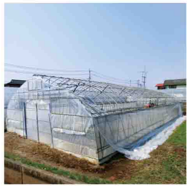
突風によるビニールの被害
