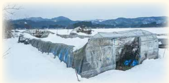
▲雪害により全損となったハウス
